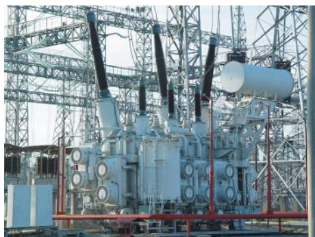
Электрические сети Электростанции, подстанции, линии электропередач
